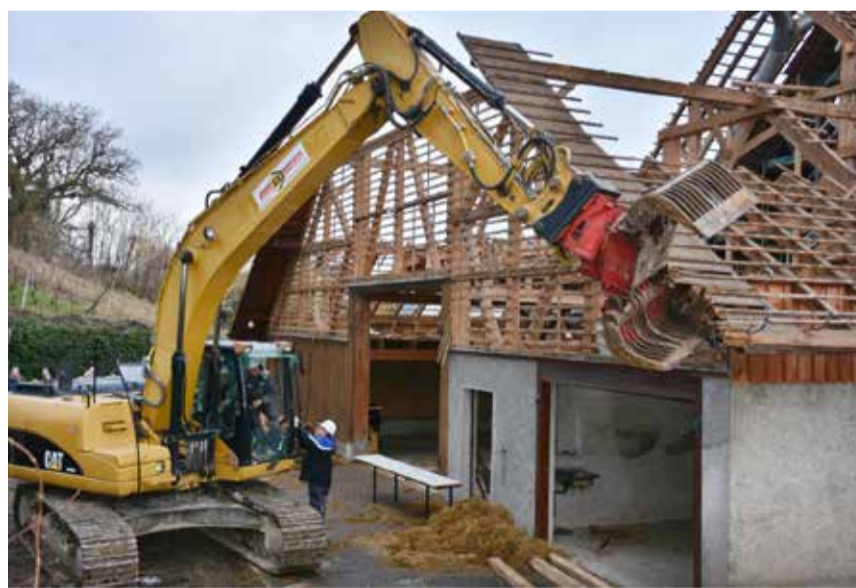
Mit dem Abbruch der alten Scheune erfolgte der Baustart. BILD THOMAS GÜNTERT
